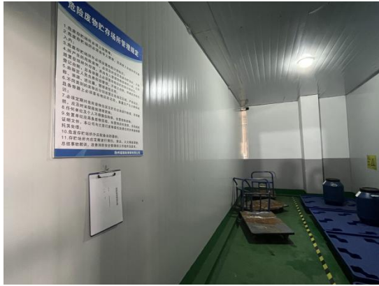
企业危废仓库监控设施
